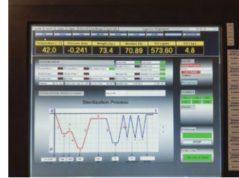
HMI Ekran, SCADA Yazılım
